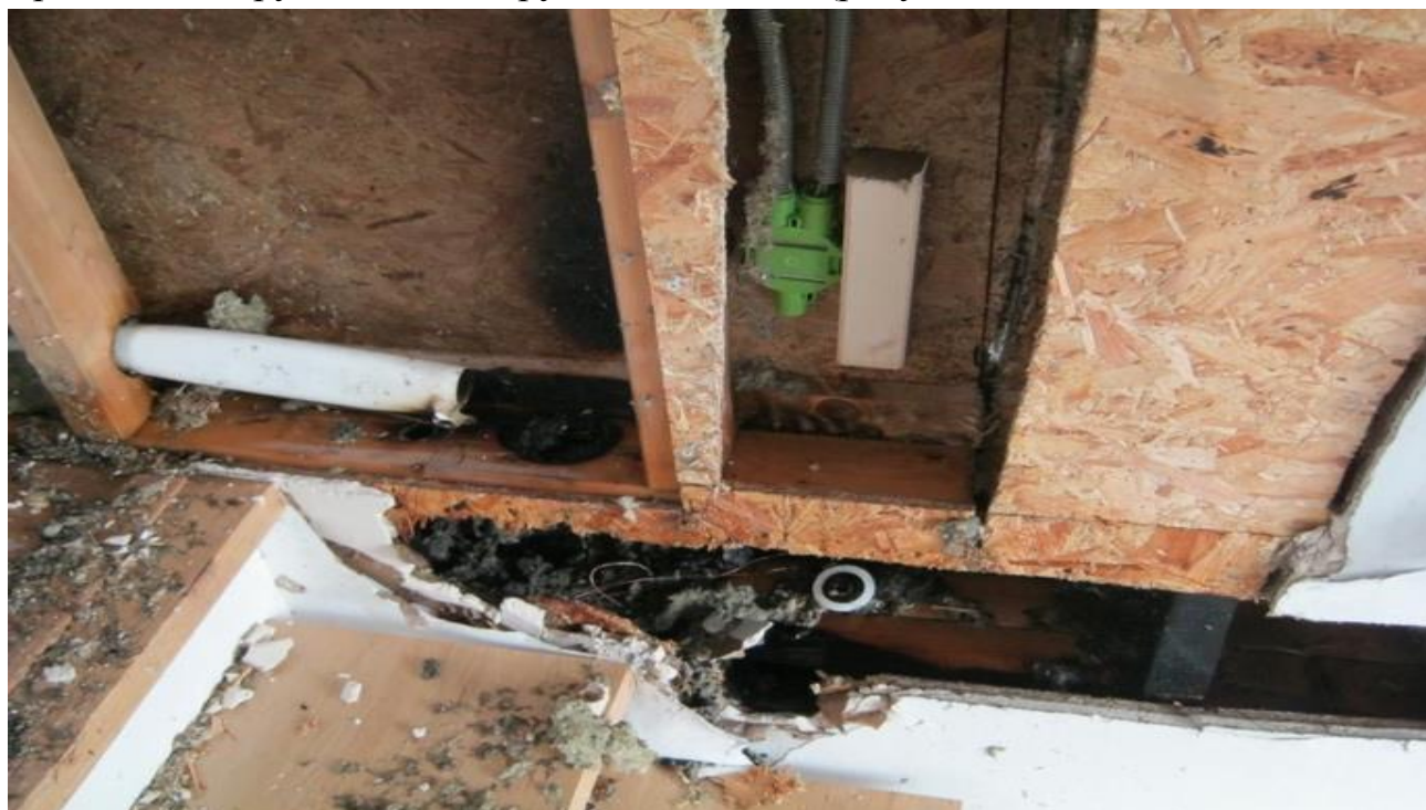
Рисунок 94. Очаг пожара внутри стены за лестницей на втором этаже
