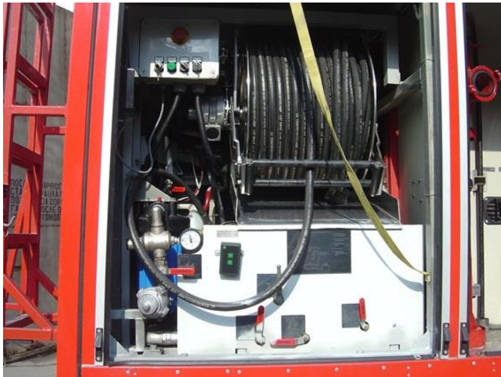
Рисунок 24. Отсек с размещением установки
